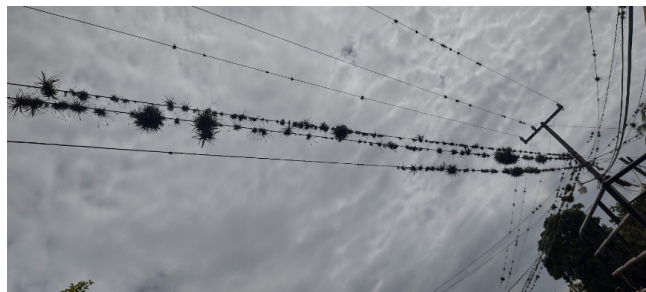
Figura 2. Exceso de epifitas en cableado eléctrico.
